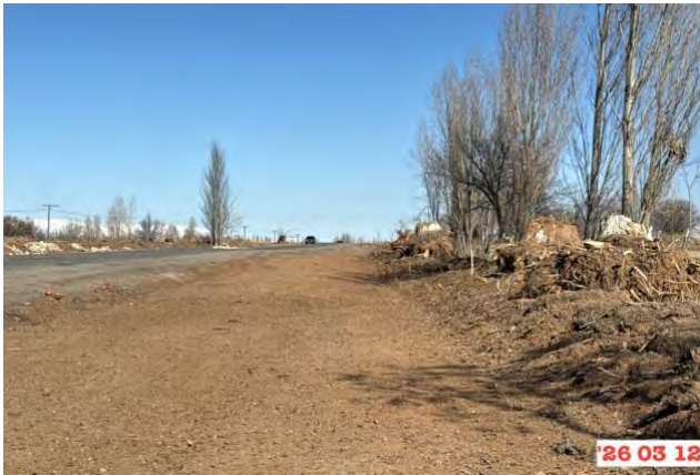
Фото 61. Км. 203. Крупные корневища вырубленных деревьев, оставленные на обочине дороги
