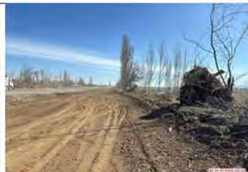
Фото 12. Км. 202+700. Крупные корневища вырубленных деревьев, оставленные на обочине дороги
