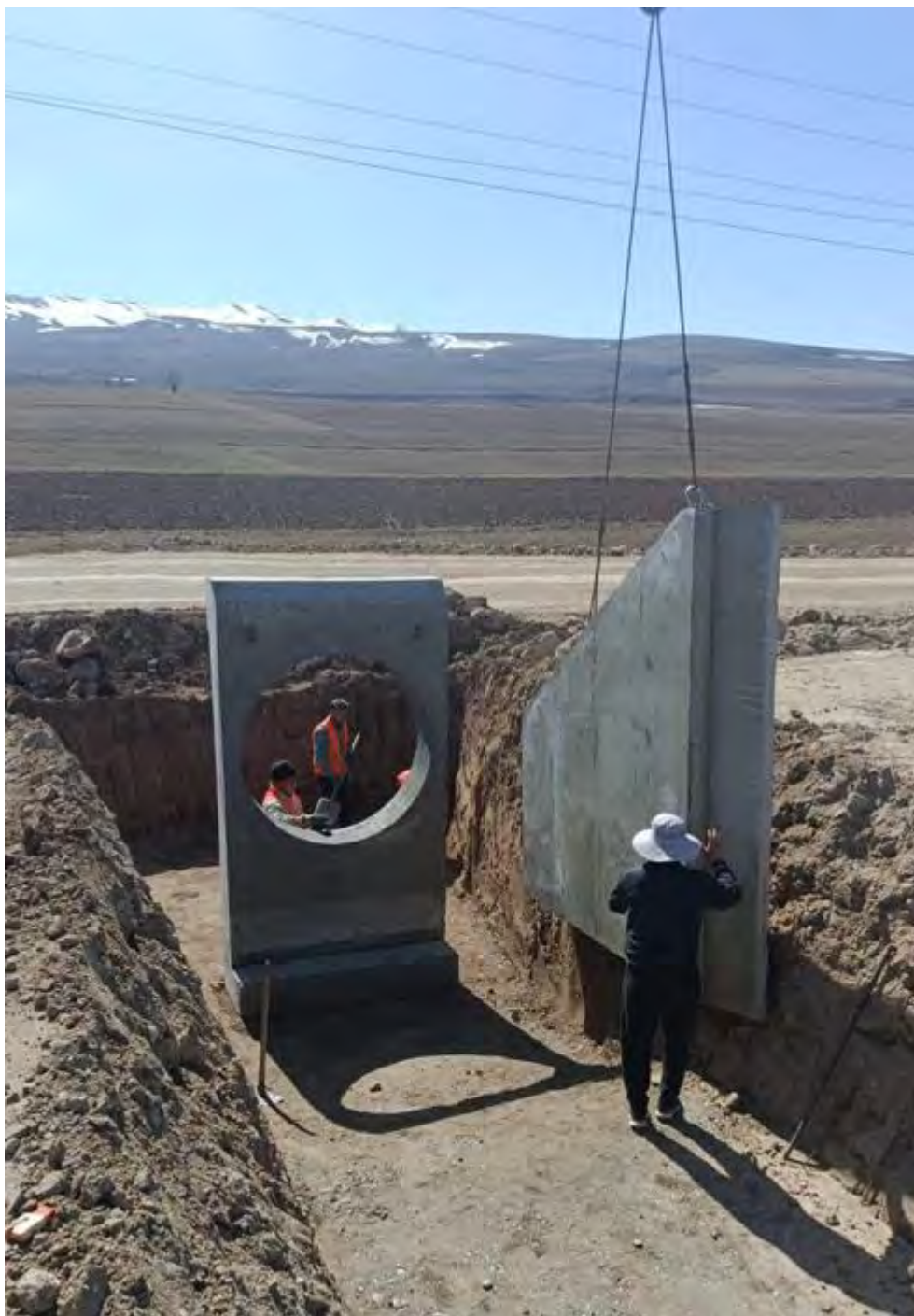
Рисунок 9: Монтаж торцевой и боковых стенок железобетонной трубы с отверстием 1,5 м на км 193+995.
