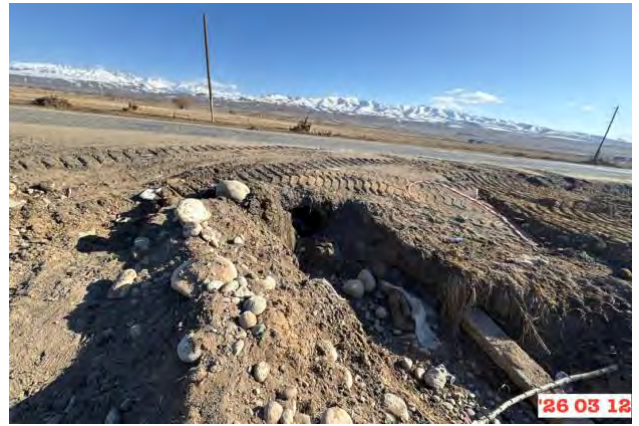
Фото 26. Водопропускная труба, на км.198 LHS, ВЫХОД
