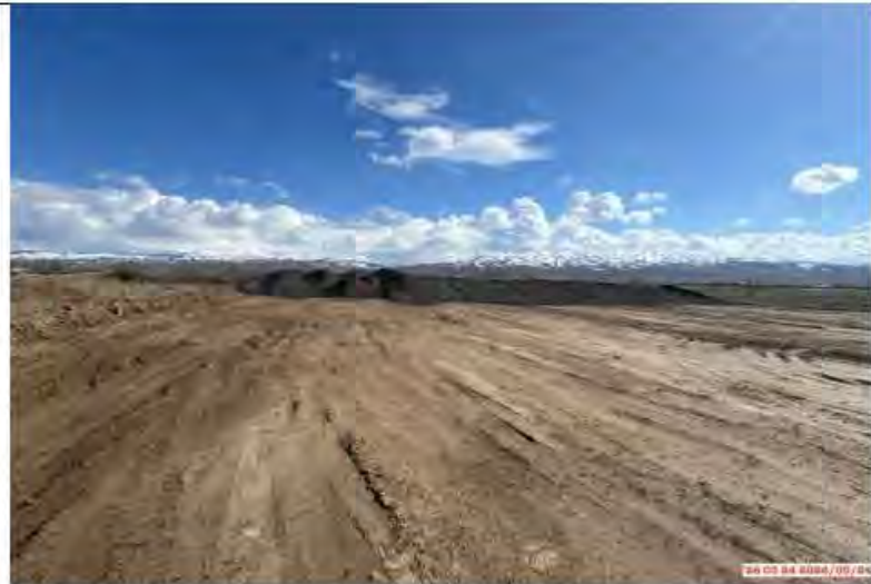
Фото 29. Отвал асфальта на км.199+500, складирован на грунтовой поверхности без обустройства защиты от загрязнения, не обеспечен водоотвод.
