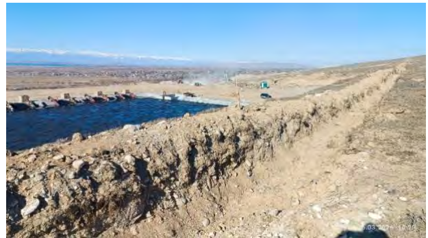
Битумохранилище на производственной базе км.202+220. Обеспечен водоотвод от битумохранилища
