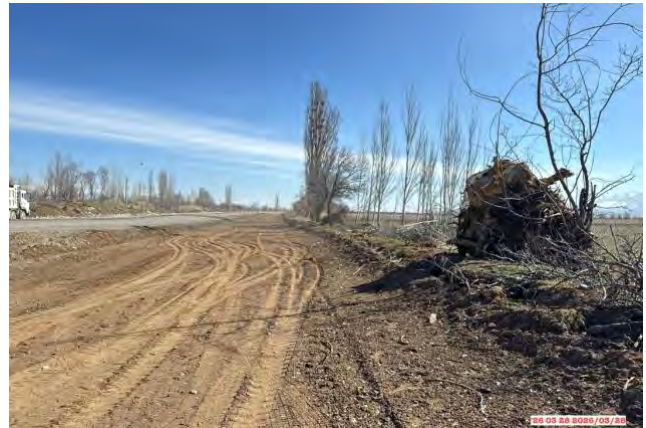
Фото 62. Км. 202+700. Крупные корневища вырубленных деревьев, оставленные на обочине дороги
