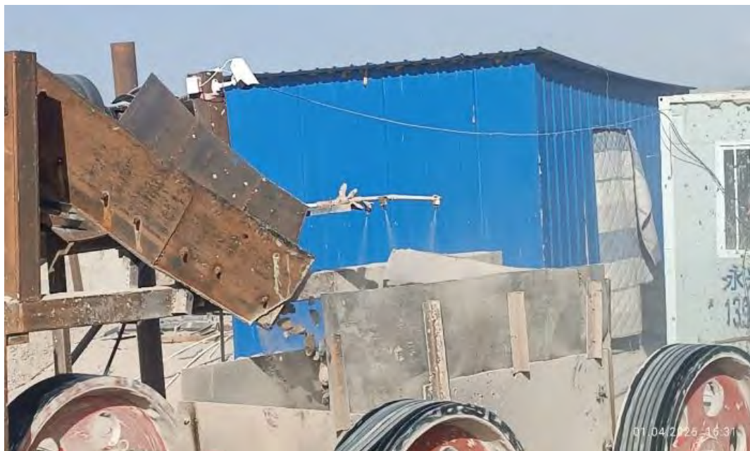
Рисунок 18: Система гидроорошения на ПГУ установлена в приемном бункере, а также на конвейрных линиях
