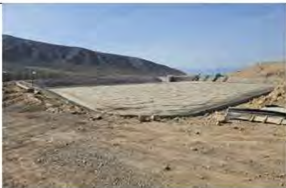
Фото 25. Битумохранилище. Отсутствие: ограждения, водоотвода атмосферных осадков, подъездных путей к битумохранилищу, оборудованной площадки для безопасного слива битума;
