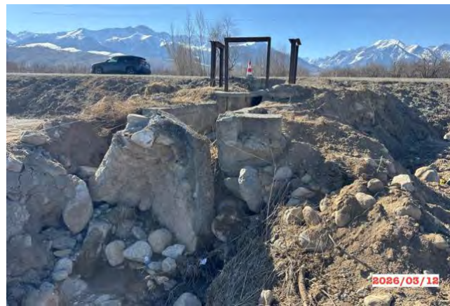
Фото 18. Водопропускная труба, на км.141+140 LHS. Выход
