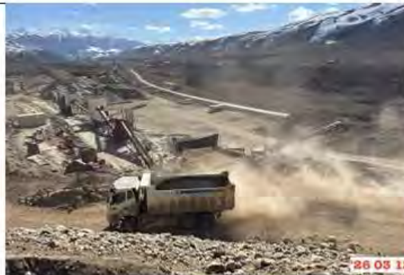
Фото 22. Производственная база, км 202+220 RHS, отсутствие гидроорошения внутри площадочных дорог.
