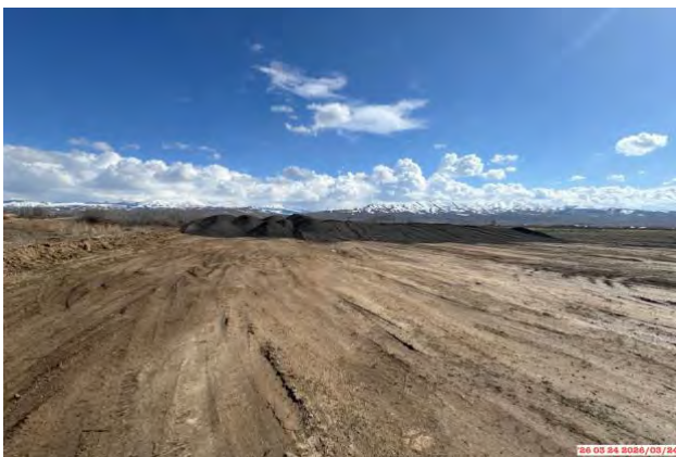
Фото 65. Отвал асфальта на км.199+500, складирован на грунтовой поверхности без обустройства защиты от загрязнения, не обеспечен водоотвод.
