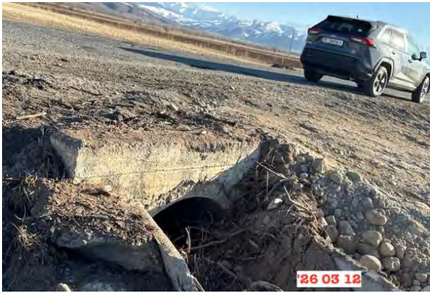
Фото 25. Водопропускная труба, на км.188+400 LHS, ВЫХОД
