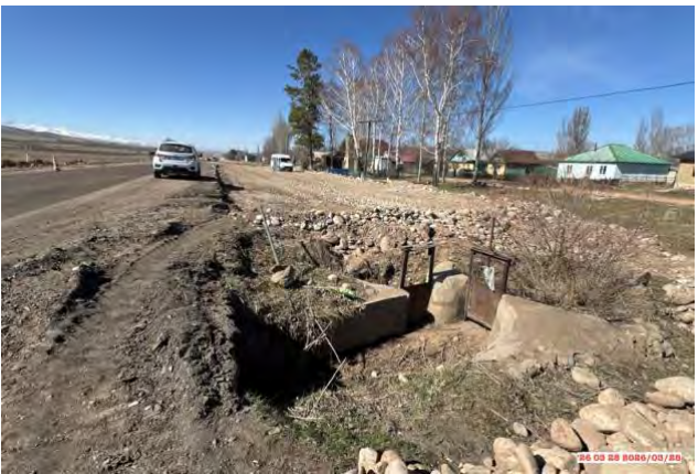
Фото 23. Водопропускная труба, на км.195+830 LHS, выход.
