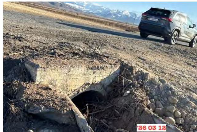
Фото 24. Водопропускная труба, на км.188+400 LHS, выход
