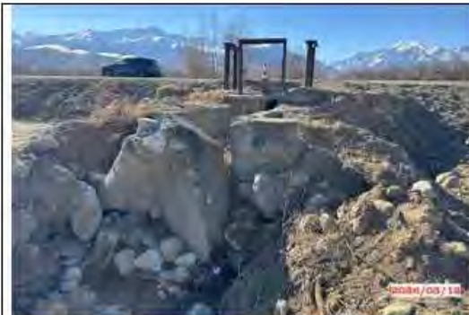
Фото 1. Водопропускная труба, на км.141+140 LHS. Выход
