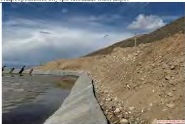
Фото 23. Битумохранилище на производственной базе км.202+220. Грунтовые откосы не укреплены и находятся в нестабильном состоянии. Существует высокий риск их обрушения, особенно в период осадков.
