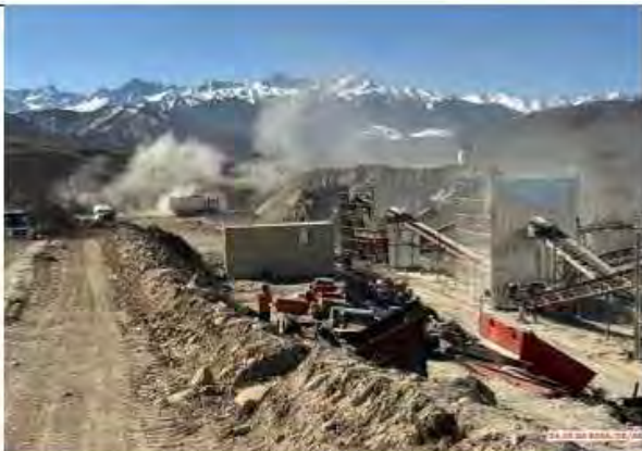
Фото 21. Производственная база, км 202+220 RHS, отсутствие гидроорошения внутри площадочных дорог
