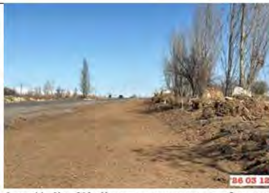
Фото 11. Км. 203. Крупные корневища вырубленных деревьев, оставленные на обочине дороги
